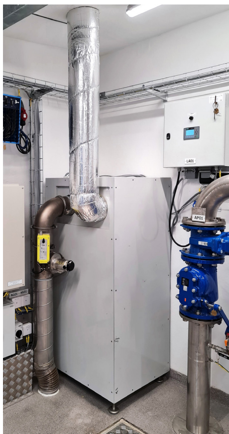
Det katalytiska systemet installerat för en pumpstation i Strömstads kommun.
