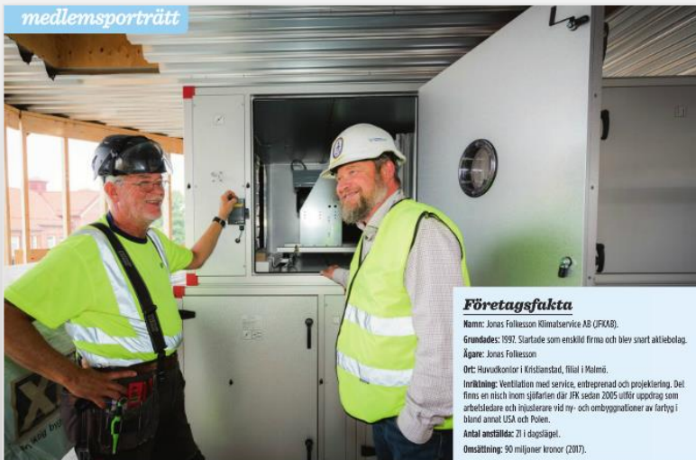
På Förskolan Björkåsen byggs det ett intelligent system med VAV. Ventilationsaggregatet som sitter i Hållrummet är själva hjärtat i huset. Här betedde monter Kaj Nilsson och Jonas Folkesson.
